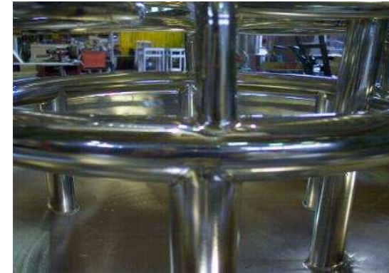
Leštěný povrch parních trubek pro výrobu čisté páry ve výměníku
