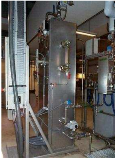
Sanitární pára v nemocnici v Slagelse.
